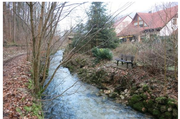
Abbildung 68: Erodierter Ufersicherung und Koniferen im Bereich angrenzender Hausgärten (Blick in Fließrichtung)
