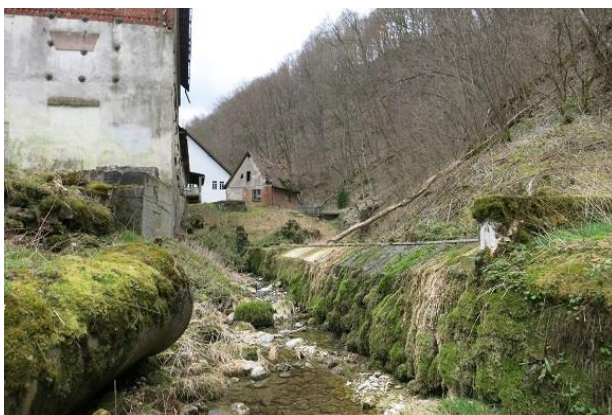
Abbildung 109: Streichwehr und im Verfall befindliche Gebäude (Blick gegen Fließrichtung)
