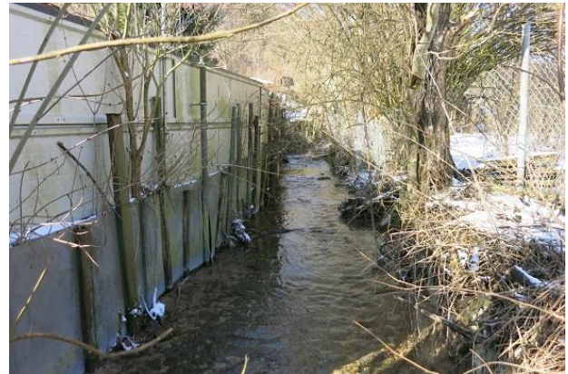
Abbildung 126: Wilder Verbau entlang der Kleingärten (Blick gegen Fließrichtung)
