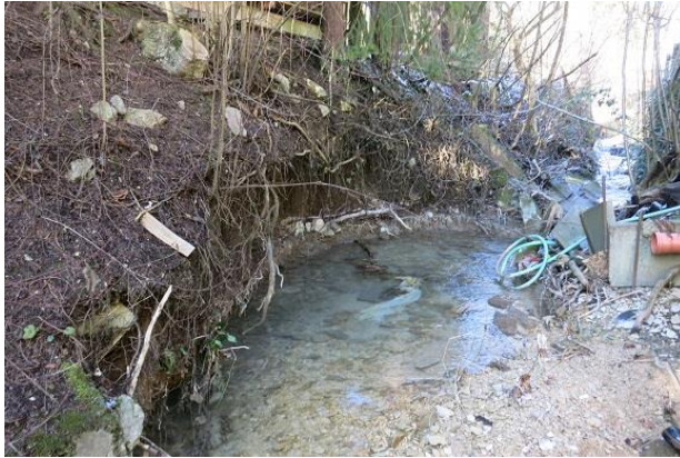
Abbildung 119: Uferabbruch entlang eines Hausgartens (Blick gegen Fließrichtung)
