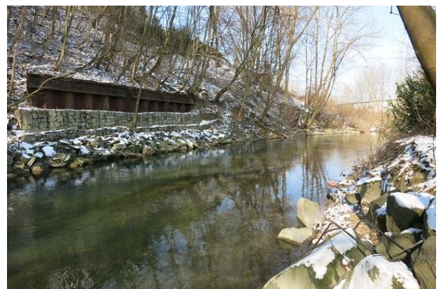
Abbildung 14: Steinwurf und Gabionen als Uferbefestigung (Blick in Fließrichtung)
