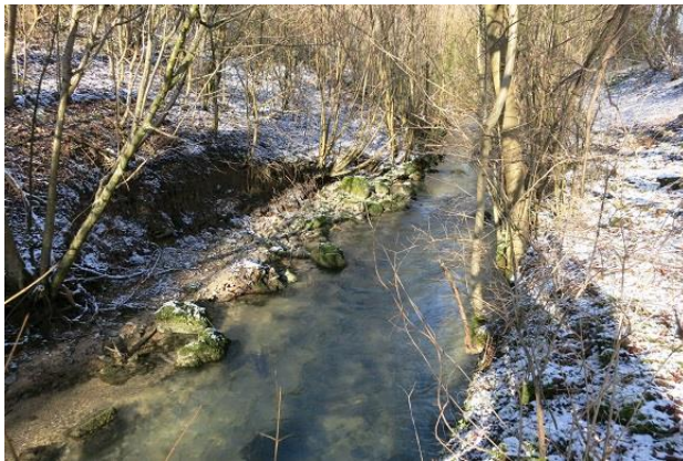
Abbildung 61: Uferabbrüche an der Eyb (Blick gegen Fließrichtung)
