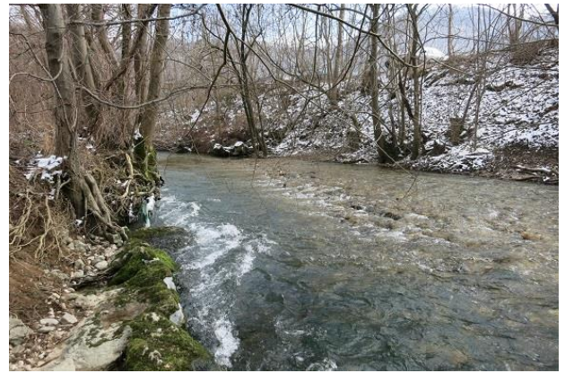
Abbildung 28: Ausgespülte Uferbefestigungen und Längsbänke in der Fils (Blick in Fließrichtung)
