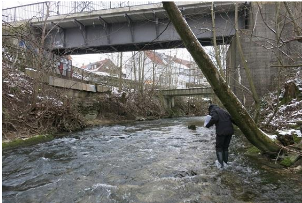
Abbildung 53: Uferabbrüche und Rest von Ufersicherungen (Blick gegen Fließrichtung)
