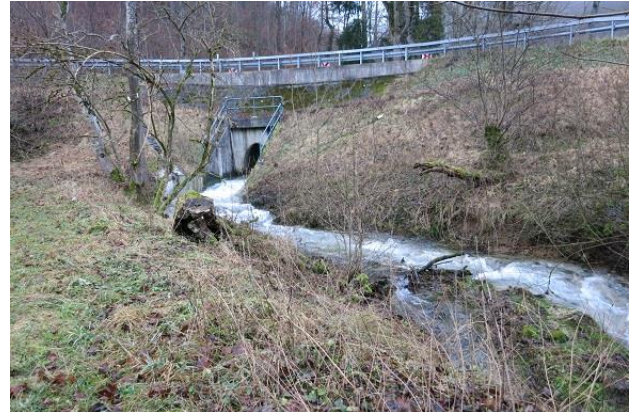
Abbildung 171: Auslauf der Verdolung im Bereich der L1221 (Blick gegen Fließrichtung)
