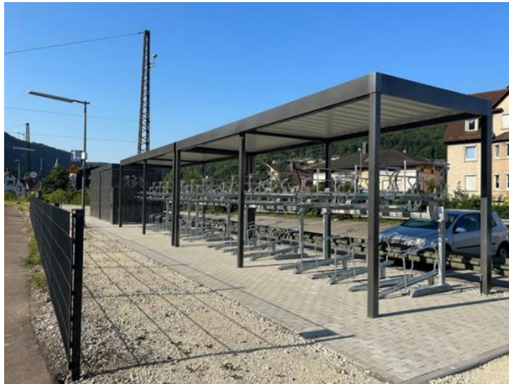
Neue Sammelschließanlage und überdachte Bügelanlagen am Bahnhof.
