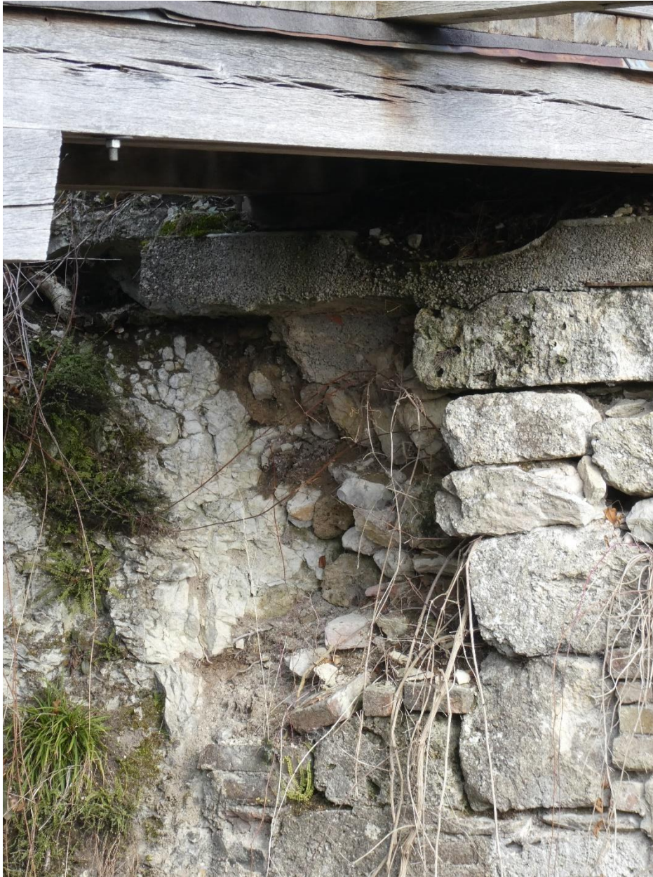
Ausbruchstelle und Übergang zum tw. losen Mauerwerk
