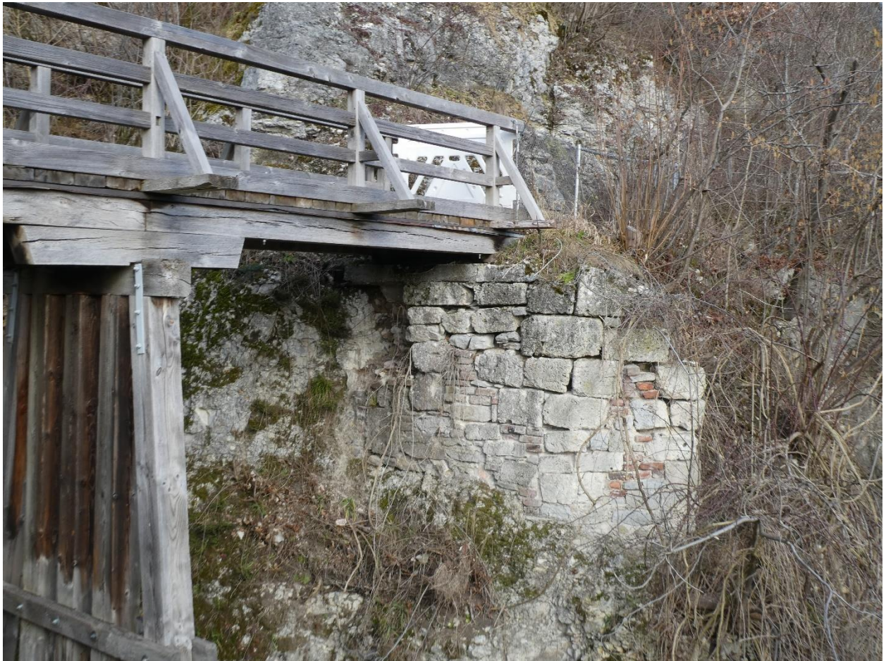
Übersicht Auflager, teilweise ausgebrochen
