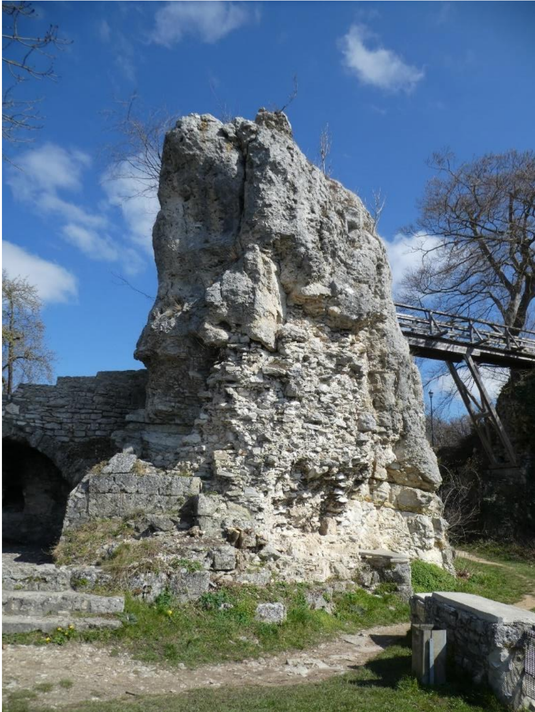
Ansicht Fels mit ausgebrochener Untermauerung
